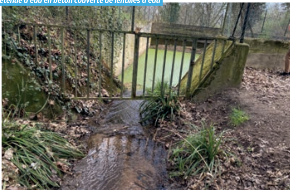
Retenue d'eau en béton couverte de lentilles d'eau
