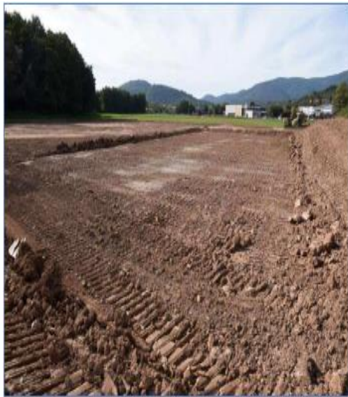
Prairie Bürkert décaissée sur 40 cm au titre de la compensation « Inondations - volumes de crues » mais sans aucune étude, ni autorisation au titre d'incidence Natura 2000, ni dérogation pour destruction d'espèces protégées (papillons Azurés à enjeux et plantes protégées), d'autant plus que ce décaissement est limitrophe au site protégé CEN Alsace-CSA en zonage Natura 2000.
