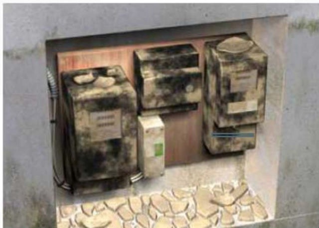
Dégradation d'un coffret de branchement extérieur
